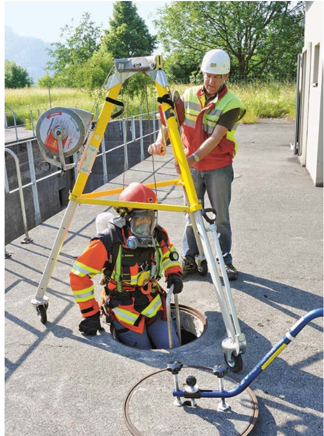
Bild 3 Beim Einstieg in einen Schacht wird die arbeitende Person durch eine zusätzliche Person direkt überwacht.
